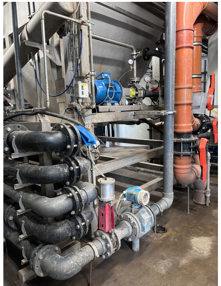
Abbildung 1: DAF-Anlage der Prozesswasseraufbereitung
