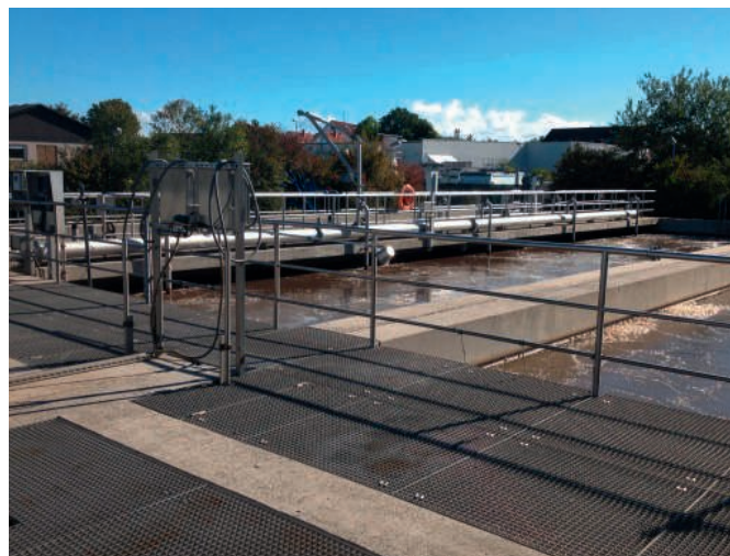
Abwasseraufbereitungsanlage mit zwei „Straßen“
